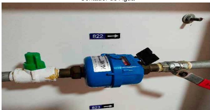
Contador de Agua
