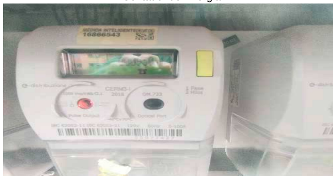
Contador de Energia
