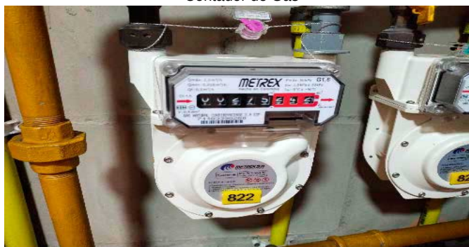
Contador de Gas
