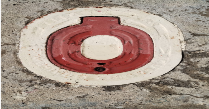
Contador de Agua
