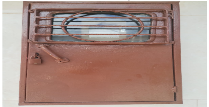
Contador de Energia
