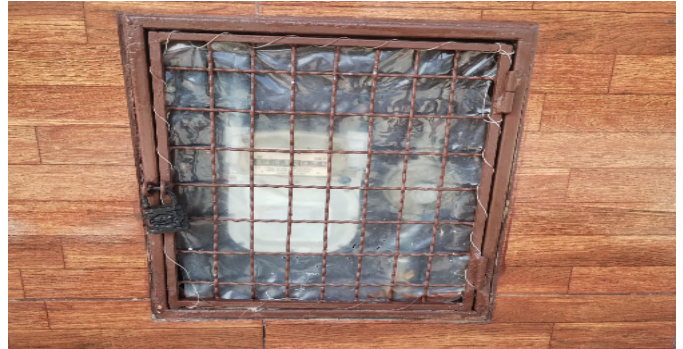
Contador de Gas
