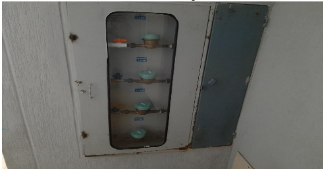
Contador de Agua
