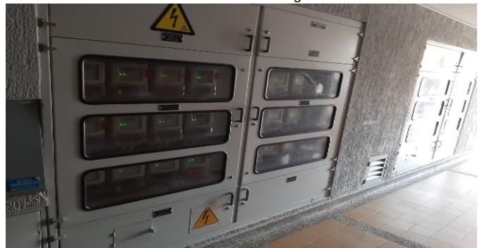
Contador de Energia
