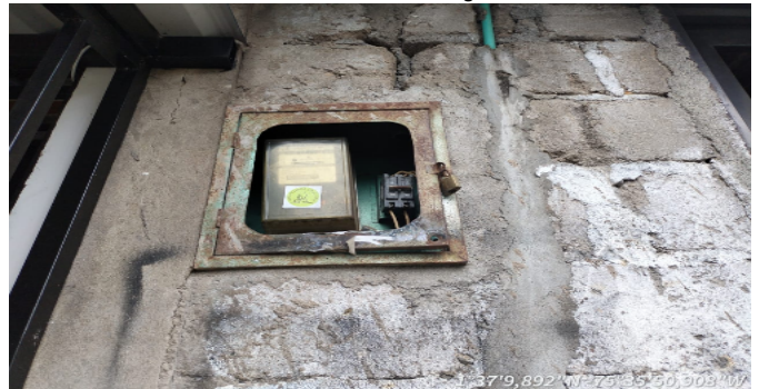
Contador de Energia
