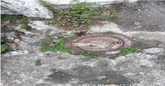
Contador de Agua
