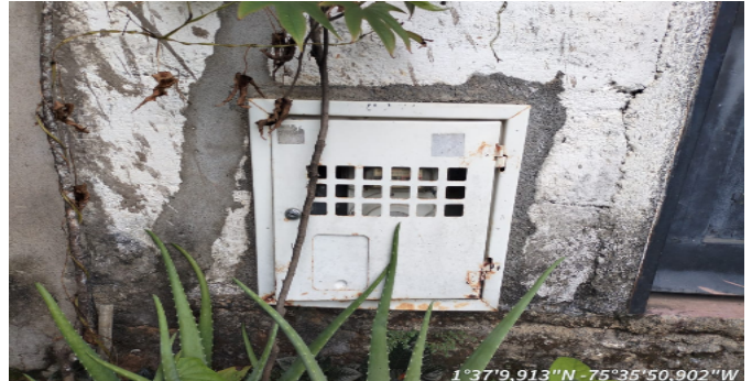
Contador de Gas
