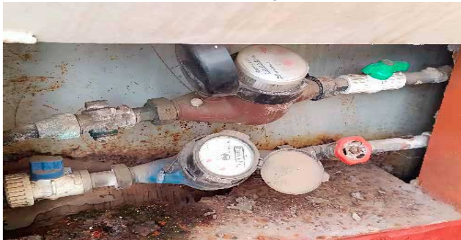
Contador de Agua
