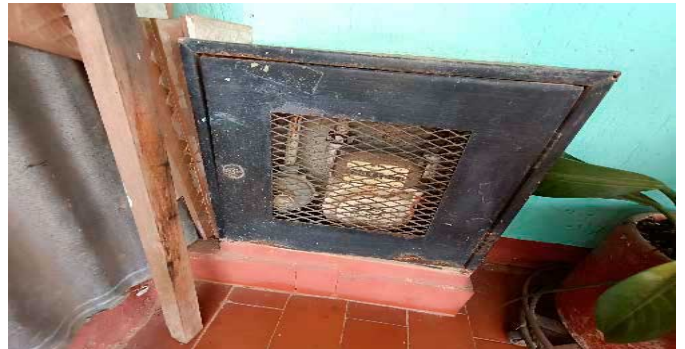
Contador de Gas
