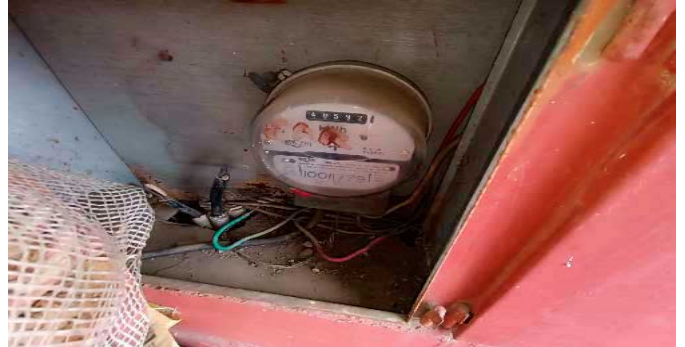
Contador de Energia
