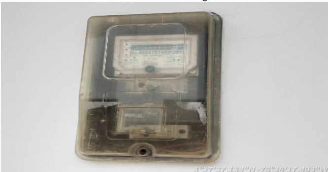
Contador de Energia
