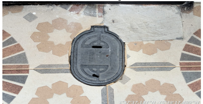
Contador de Agua
