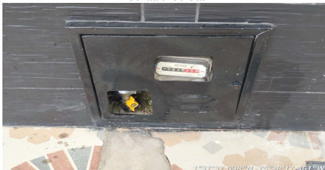
Contador de Gas
