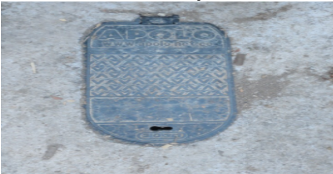
Contador de Agua
