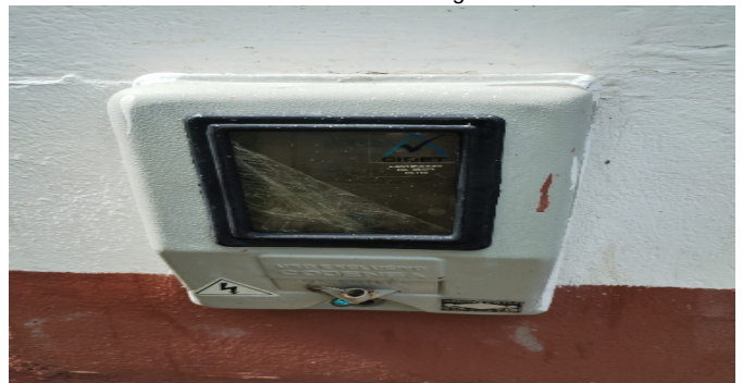
Contador de Energia
