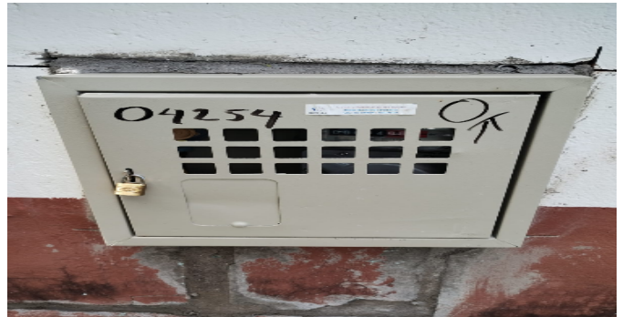
Contador de Gas
