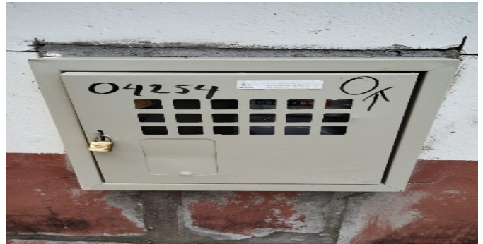
Contador de Gas
