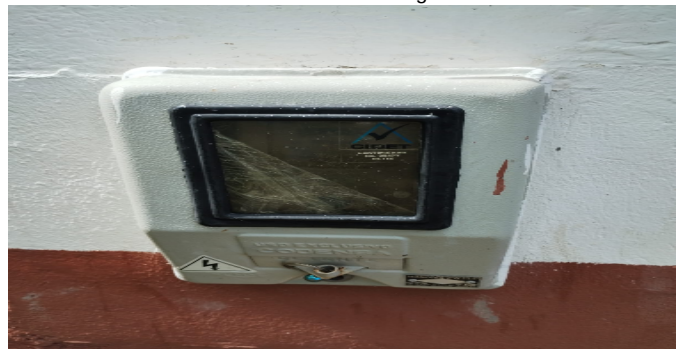
Contador de Energia
