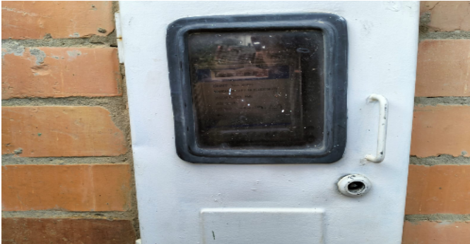
Contador de Energia
