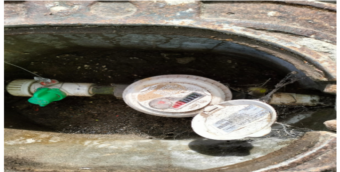
Contador de Agua
