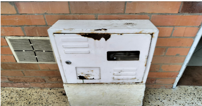
Contador de Gas
