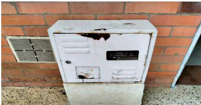
Contador de Gas
