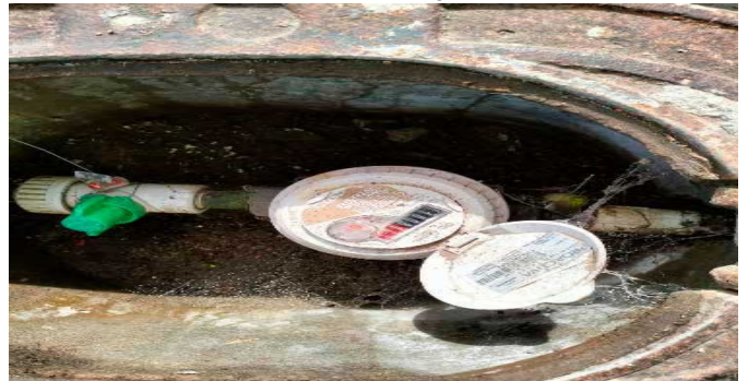
Contador de Agua
