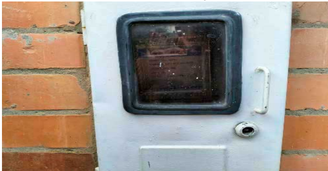
Contador de Energia
