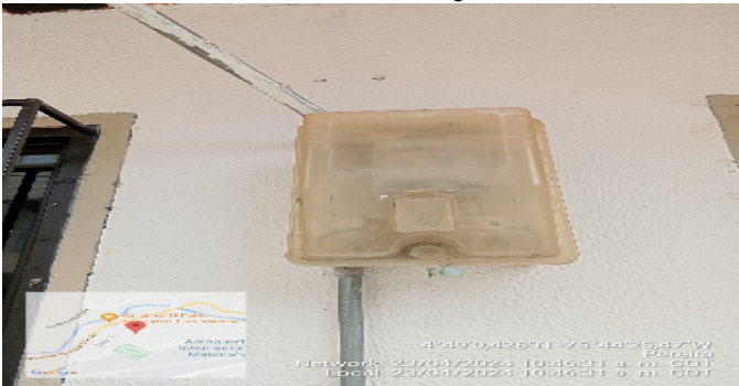
Contador de Energia
