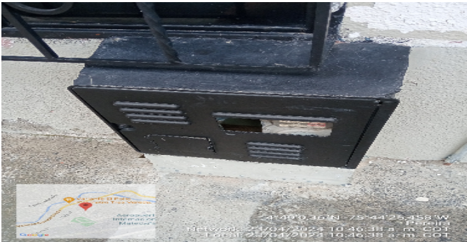
Contador de Gas
