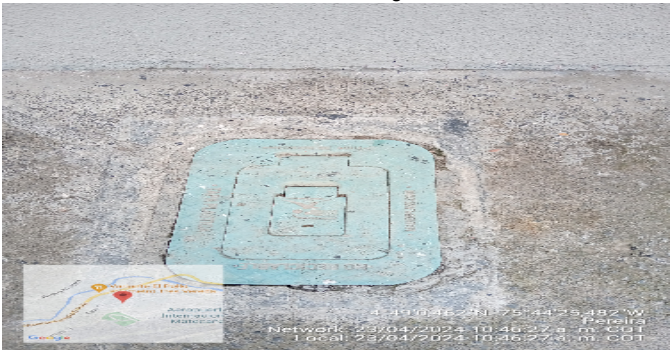
Contador de Agua
