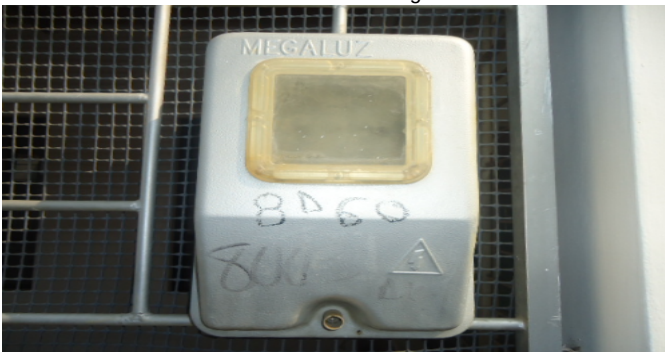
Contador de Energia
