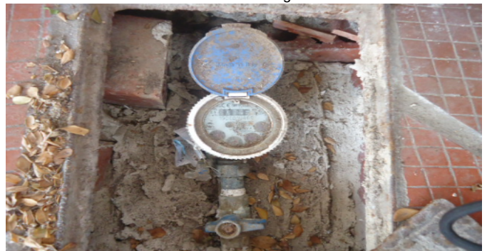
Contador de Agua
