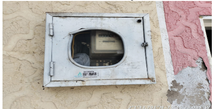
Contador de Energia
