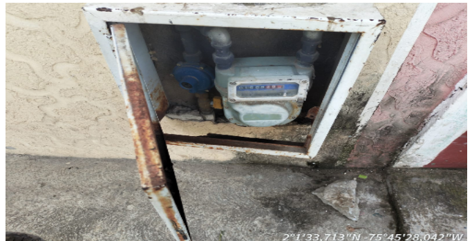
Contador de Gas
