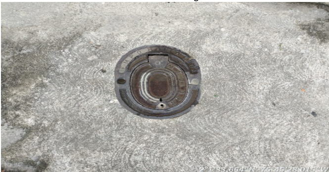
Contador de Agua
