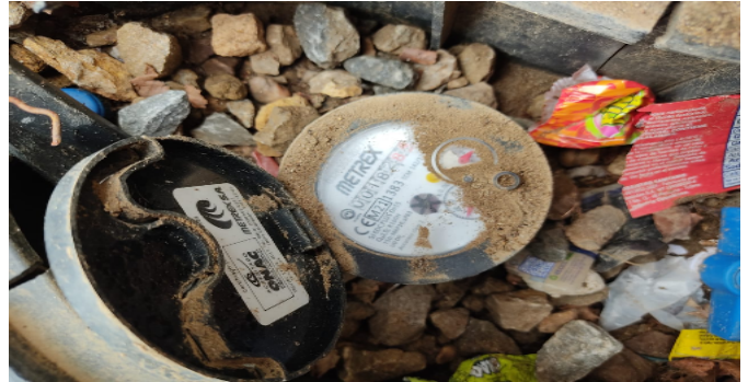
Contador de Agua
