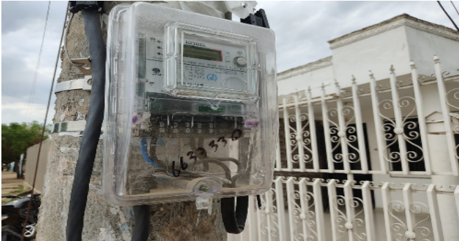
Contador de Energia
