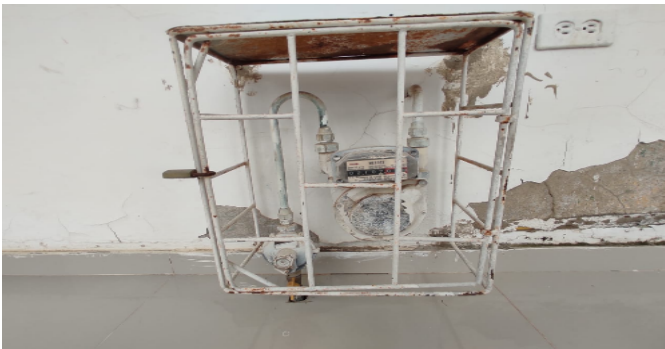
Contador de Gas
