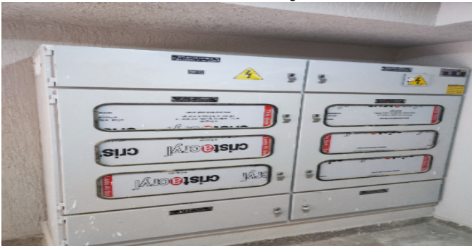
Contador de Energia
