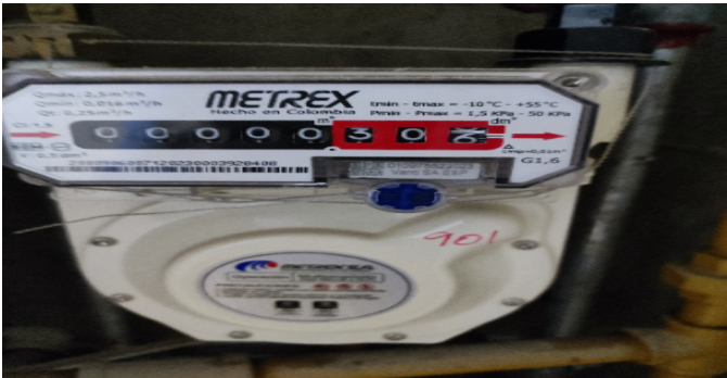
Contador de Gas
