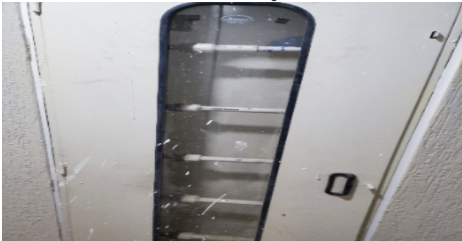
Contador de Agua
