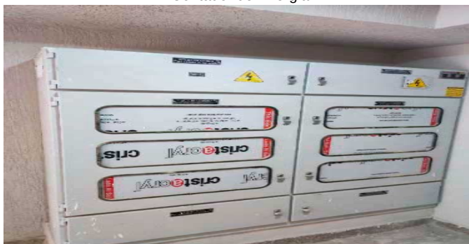
Contador de Energia
