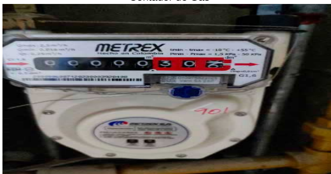
Contador de Gas
