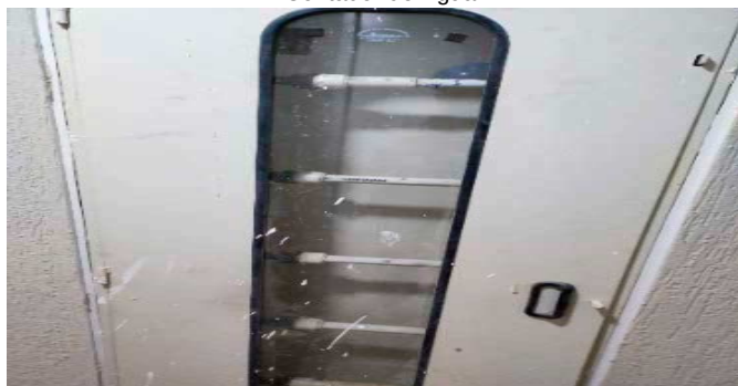
Contador de Agua
