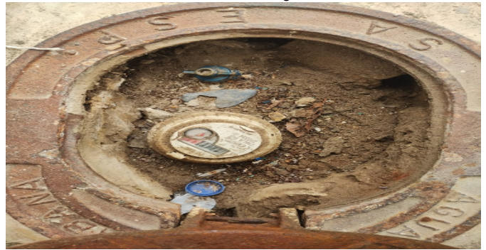
Contador de Agua
