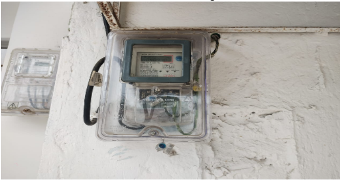
Contador de Energia
