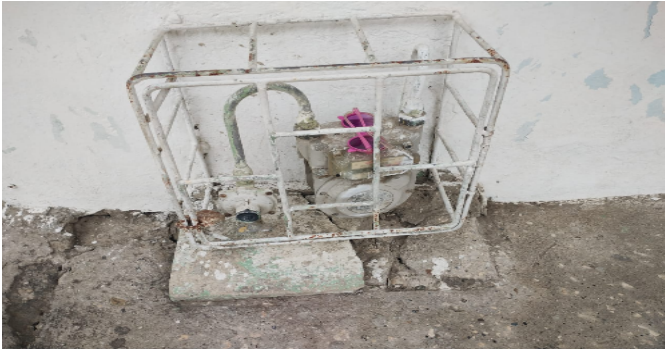
Contador de Gas
