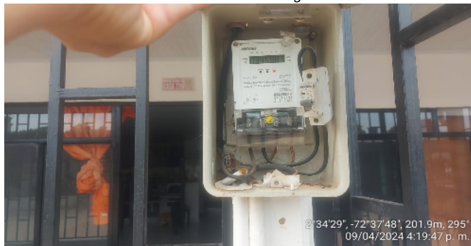
Contador de Energia
