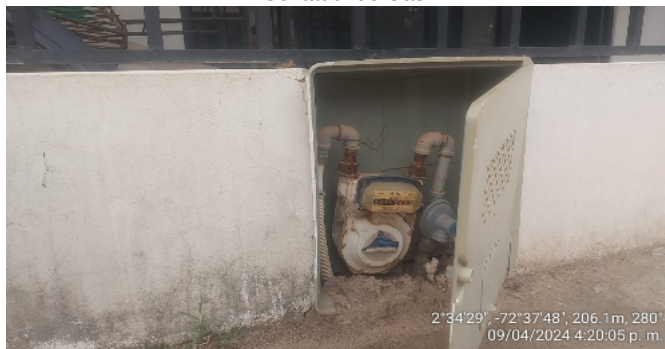
Contador de Gas
