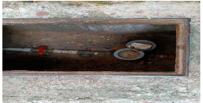
Contador de Agua
