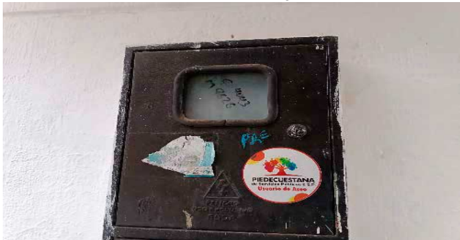
Contador de Energia
