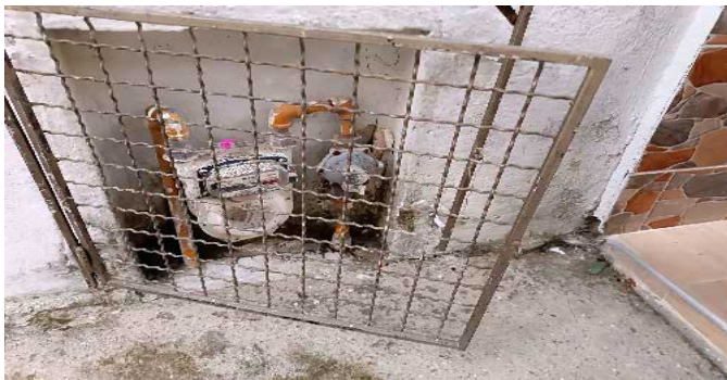
Contador de Gas
