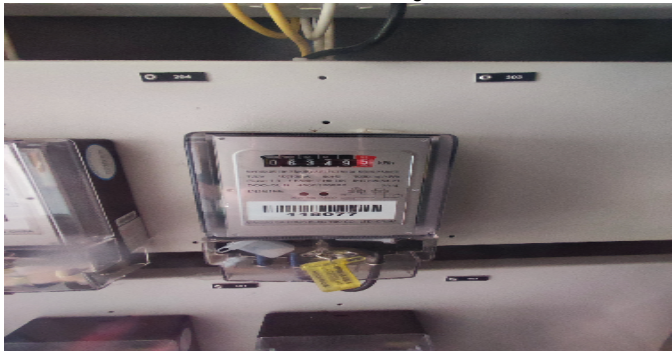
Contador de Energia
