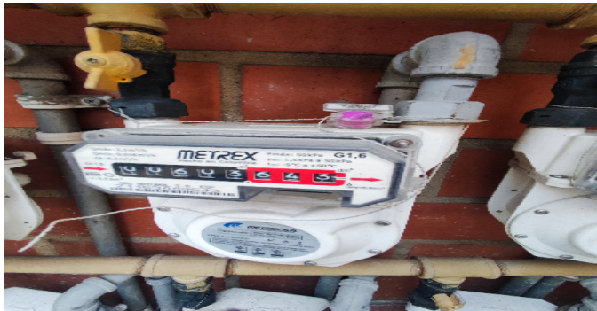
Contador de Gas
