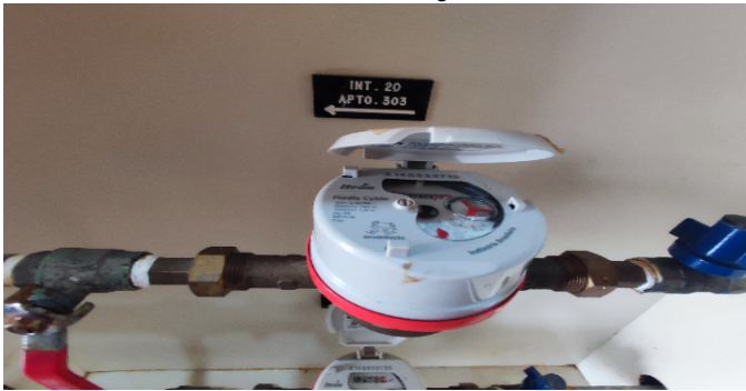
Contador de Agua
