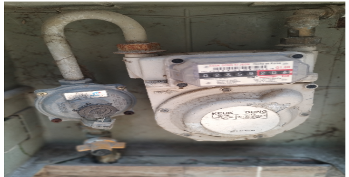
Contador de Gas
