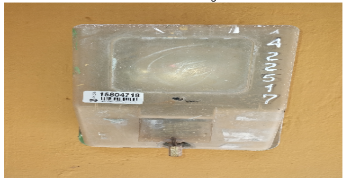
Contador de Energia
