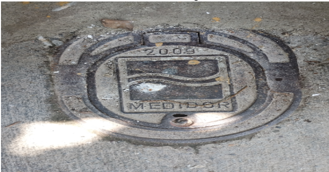
Contador de Agua
