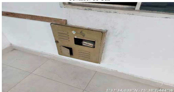
Contador de Gas
