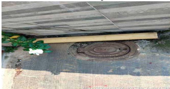
Contador de Agua
