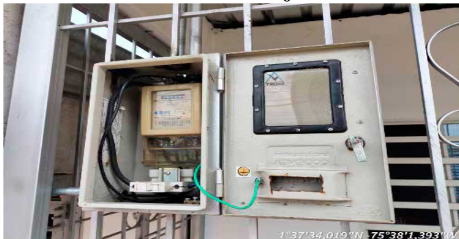
Contador de Energía
