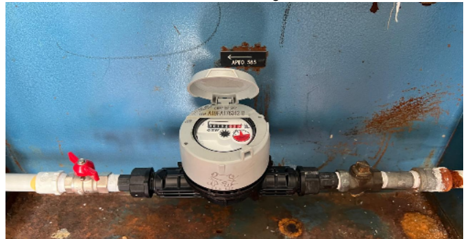
Contador de Agua
