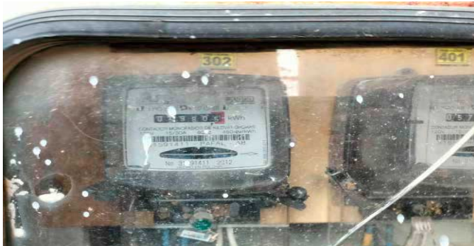
Contador de Energía
