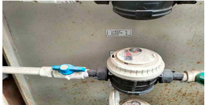
Contador de Agua
