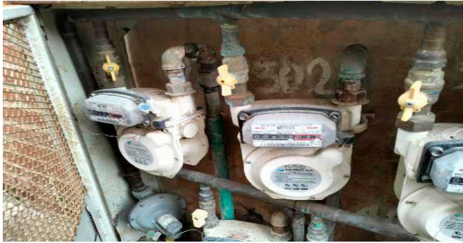
Contador de Gas
