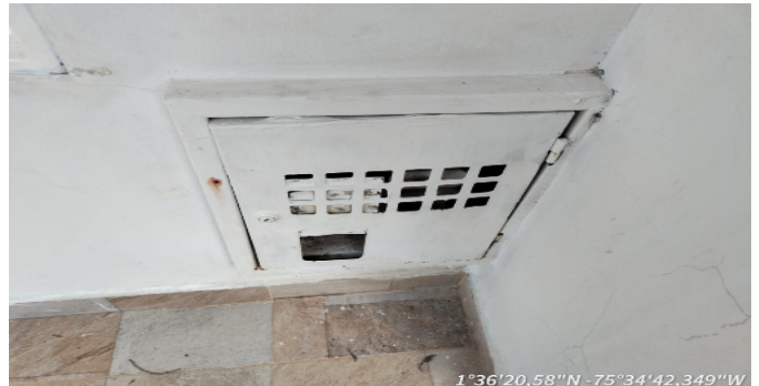
Contador de Gas
