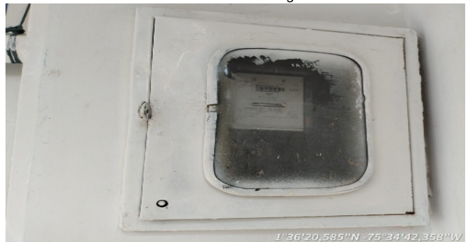
Contador de Energia
