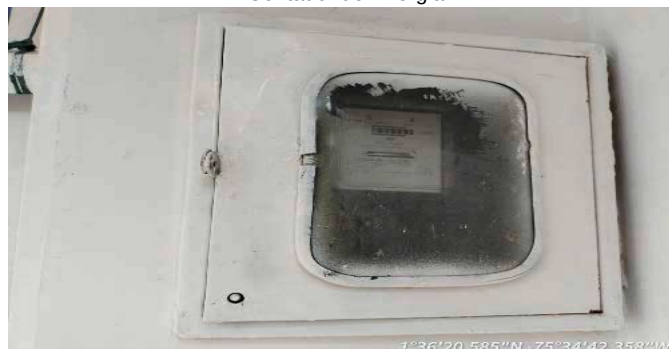
Contador de Energia
