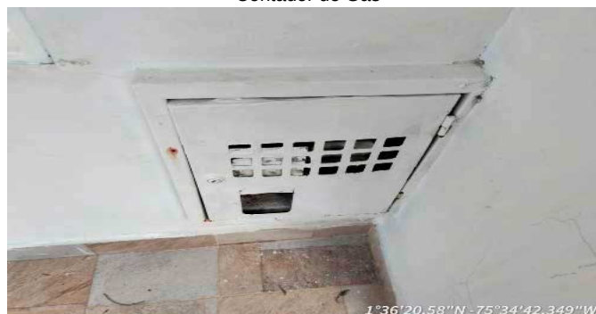
Contador de Gas
