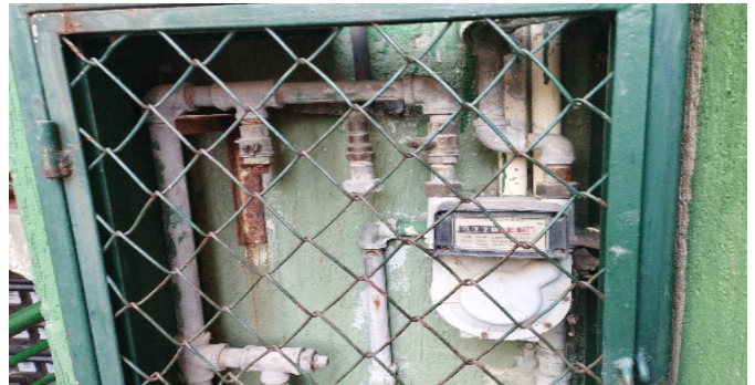
Contador de Gas
