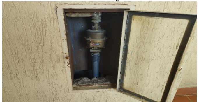
Contador de Agua
