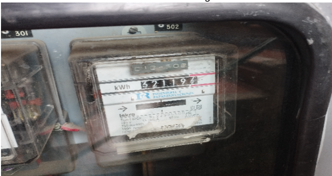
Contador de Energia
