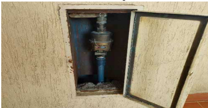
Contador de Agua
