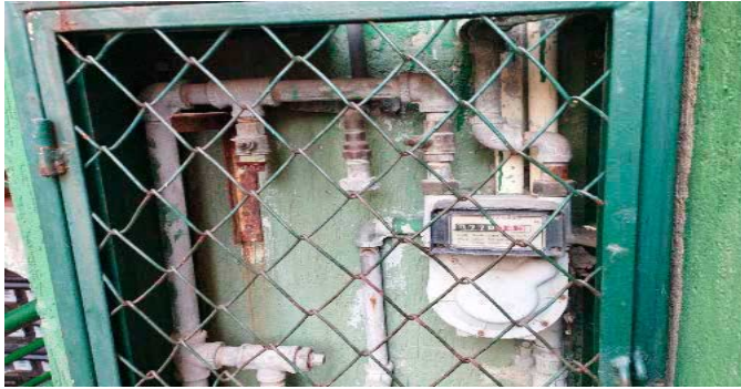
Contador de Gas
