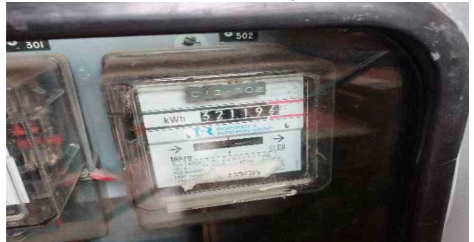
Contador de Energia
