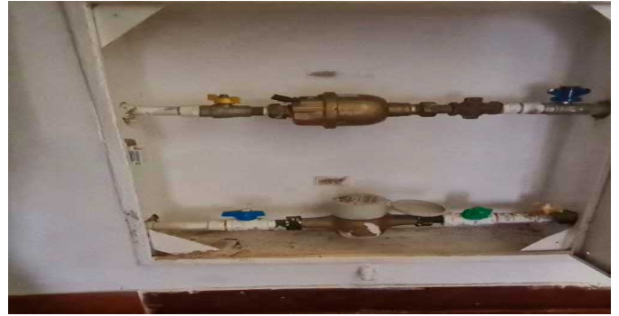
Contador de Agua
