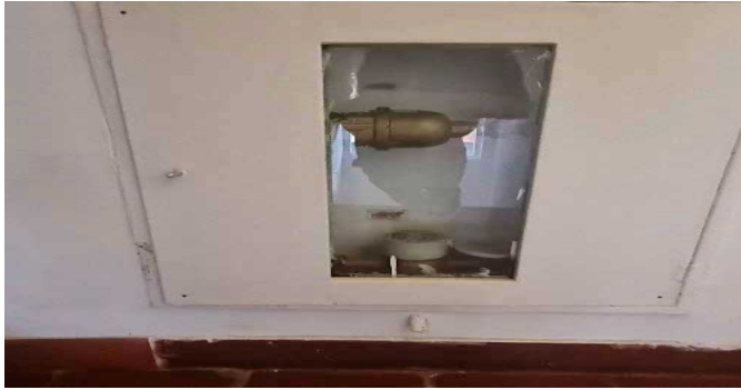
Contador de Agua
