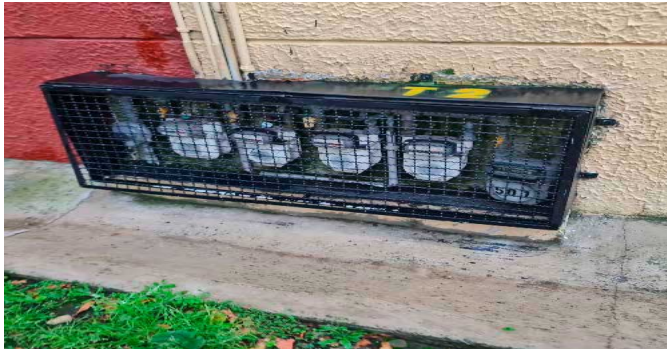
Contador de Gas
