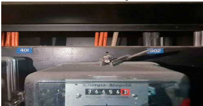
Contador de Energia
