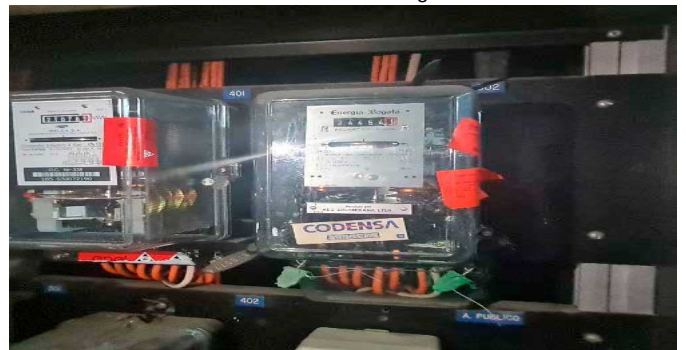
Contador de Energia
