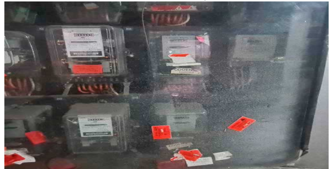
Contador de Energia
