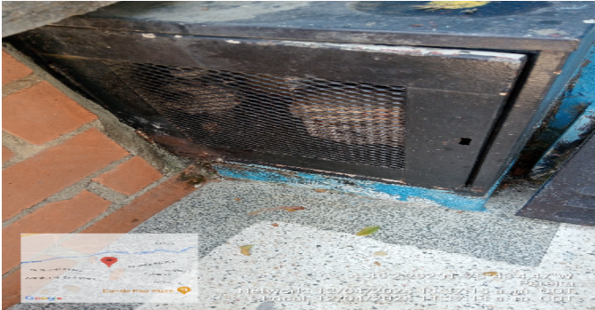
Contador de Gas
