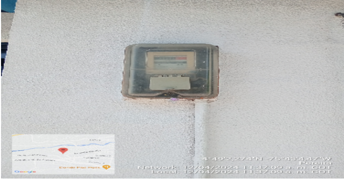
Contador de Energia
