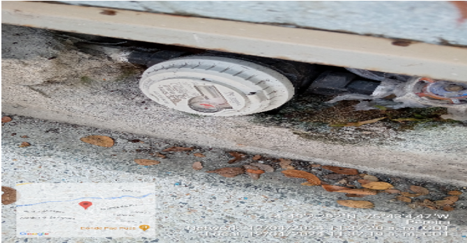
Contador de Agua
