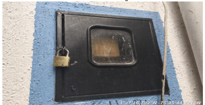
Contador de Energia
