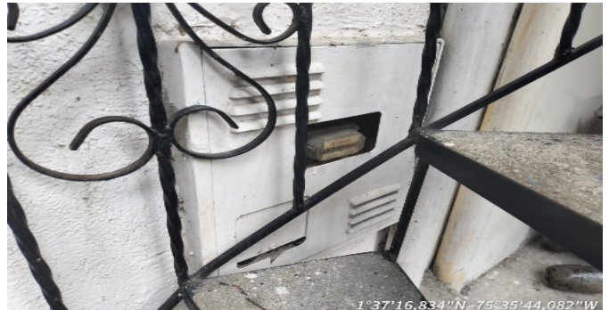
Contador de Gas
