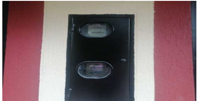
Contador de Energia
