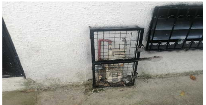
Contador de Gas
