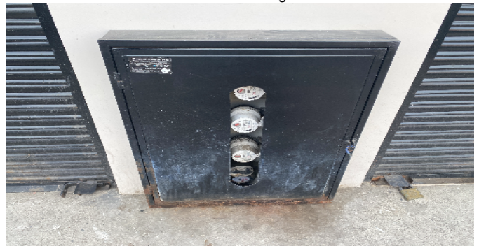
Contador de Agua
