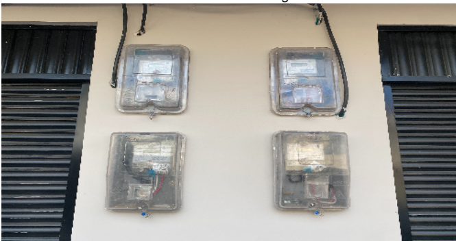
Contador de Energia
