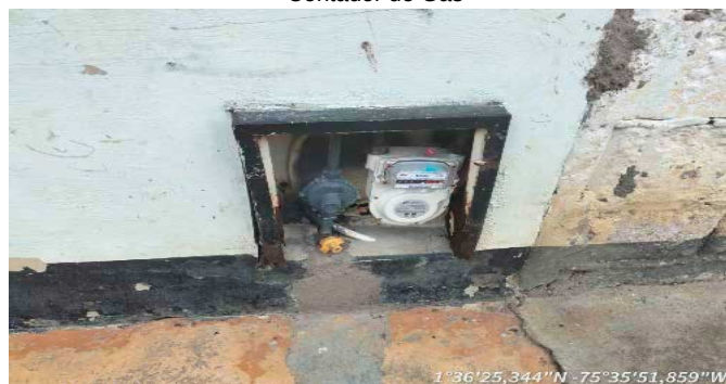
Contador de Gas
