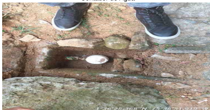
Contador de Agua
