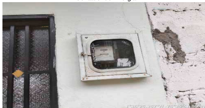
Contador de Energia
