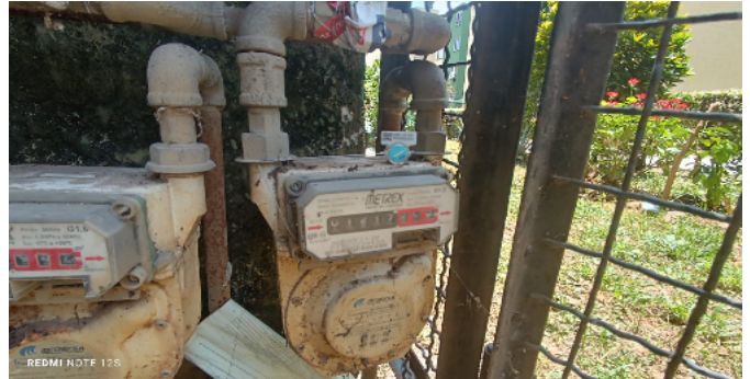
Contador de Gas
