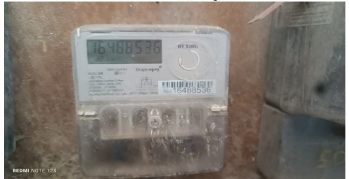
Contador de Energia
