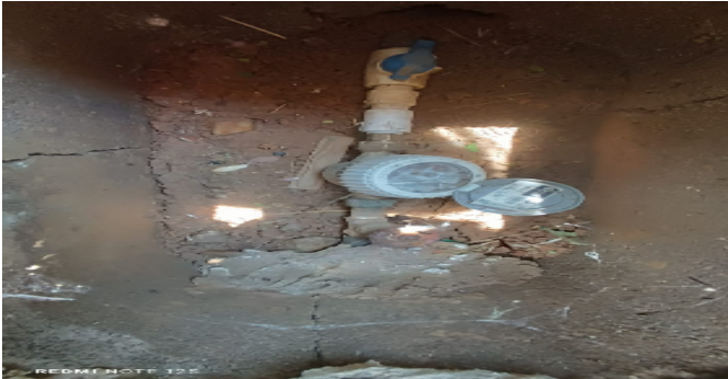
Contador de Agua
