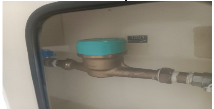
Contador de Agua
