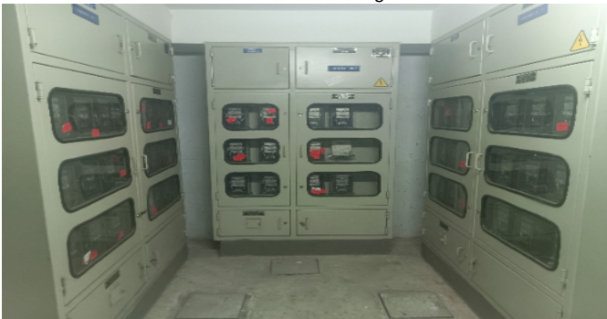
Contador de Energia
