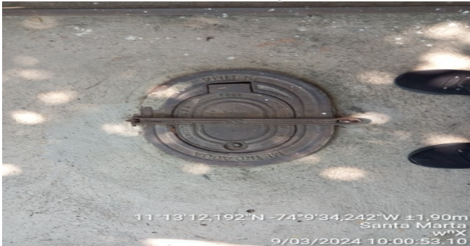
Contador de Agua
