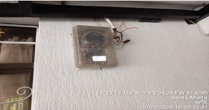
Contador de Energia
