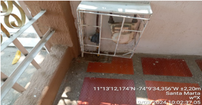
Contador de Gas
