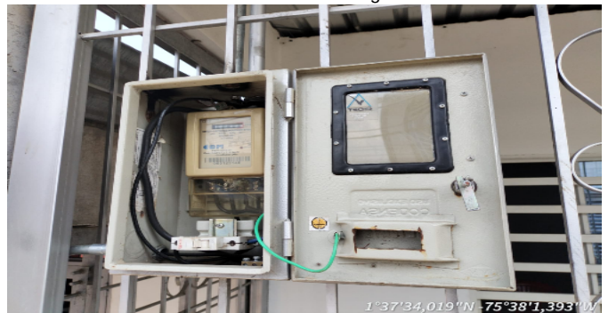
Contador de Energia
