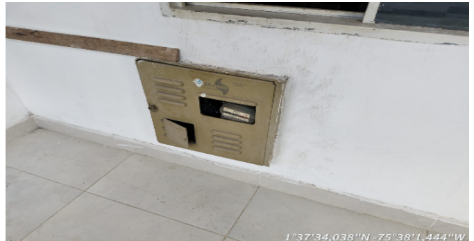
Contador de Gas
