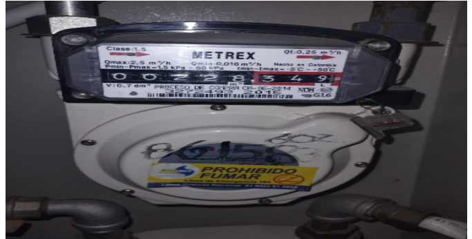
Contador de Gas
