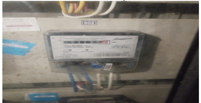
Contador de Energia
