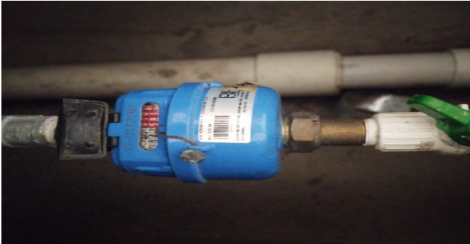
Contador de Agua
