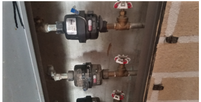
Contador de Agua
