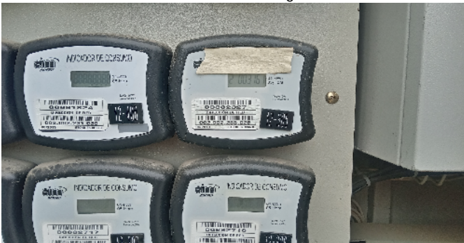
Contador de Energia
