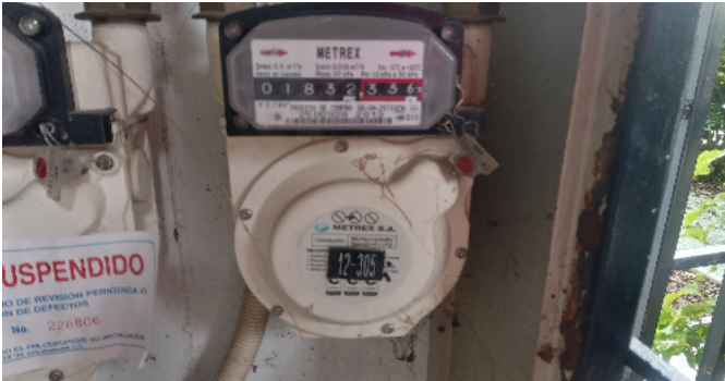
Contador de Gas
