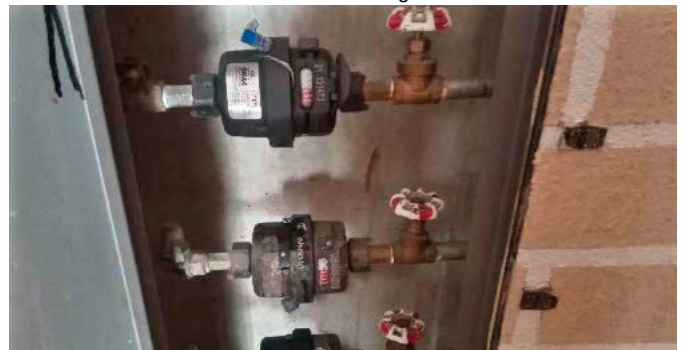
Contador de Agua
