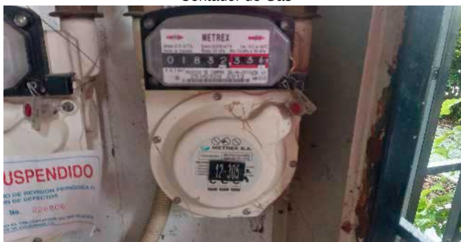
Contador de Gas
