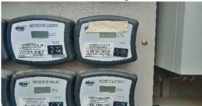
Contador de Energia
