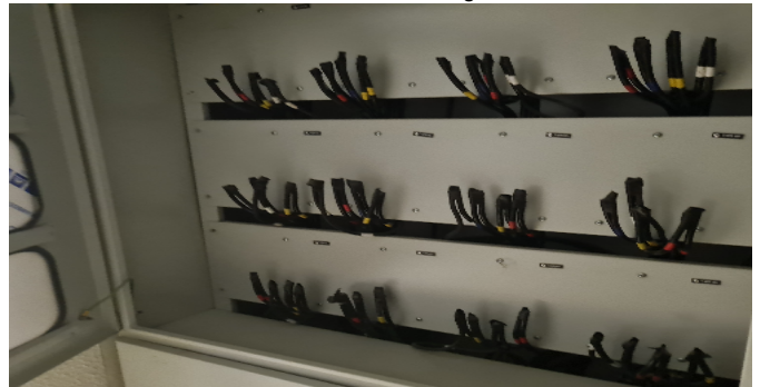
Contador de Energia
