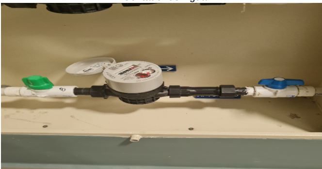
Contador de Agua
