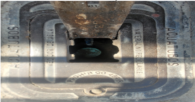
Contador de Agua
