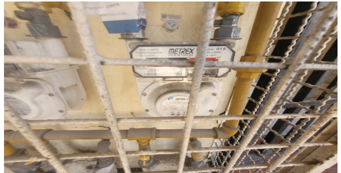
Contador de Gas
