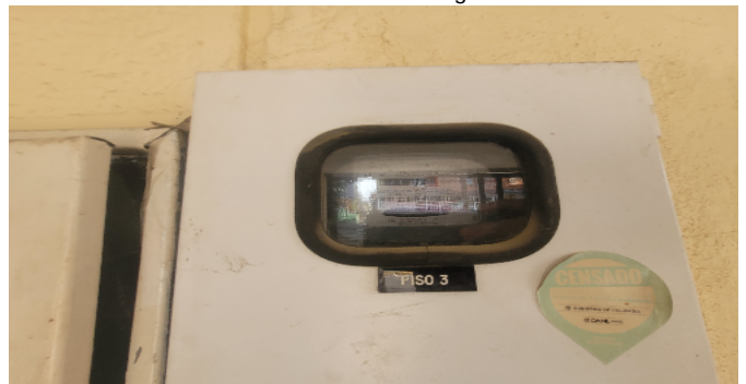
Contador de Energia
