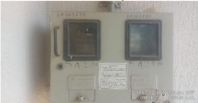
Contador de Energia
