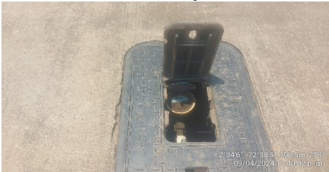
Contador de Agua
