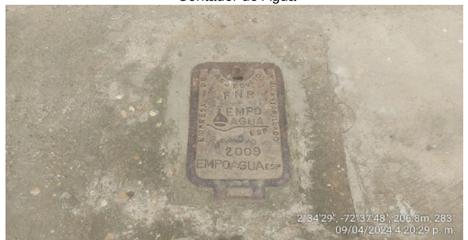
Contador de Agua
