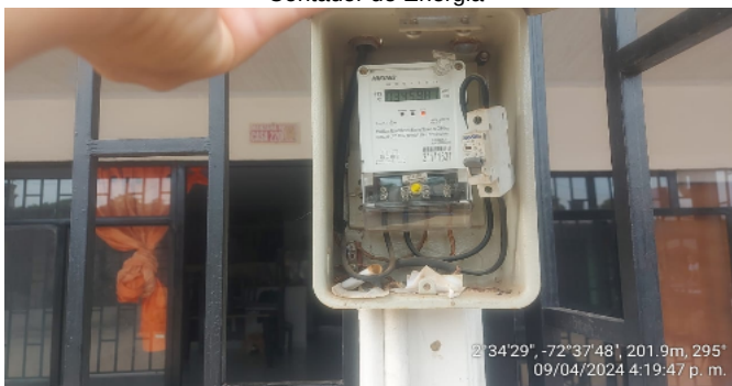
Contador de Energia
