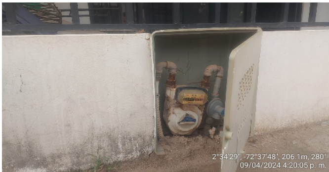
Contador de Gas
