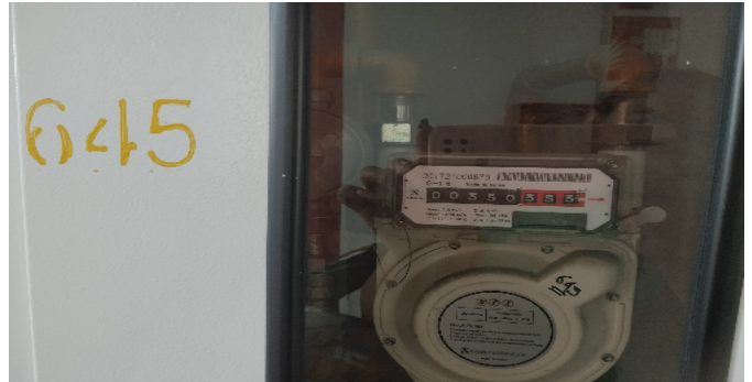
Contador de Gas
