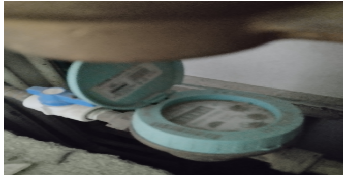
Contador de Agua
