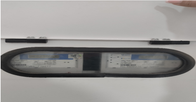
Contador de Energia
