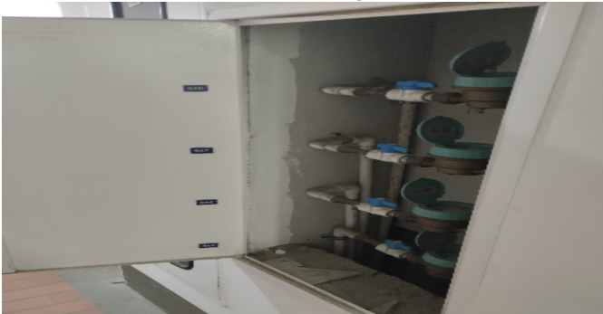
Contador de Agua
