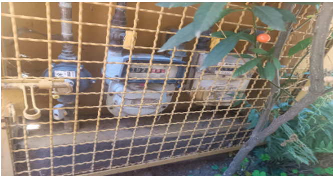
Contador de Gas
