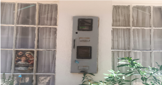
Contador de Energia
