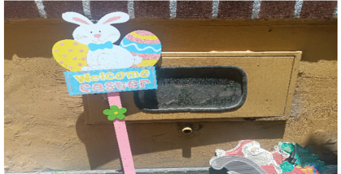
Contador de Agua
