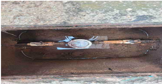
Contador de Agua
