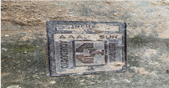
Contador de Agua
