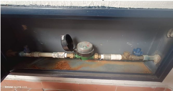
Contador de Agua
