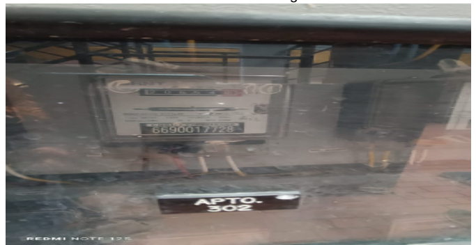
Contador de Energia
