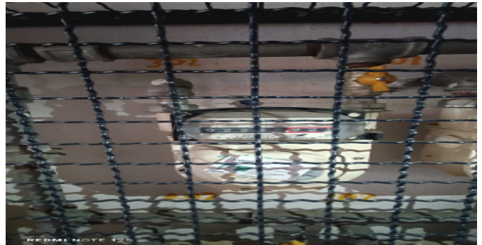
Contador de Gas
